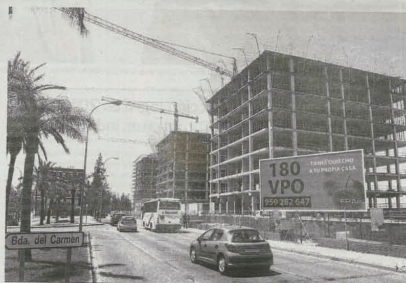
Construcción de una promoción de viviendas en régimen de VPO en Huelva.
